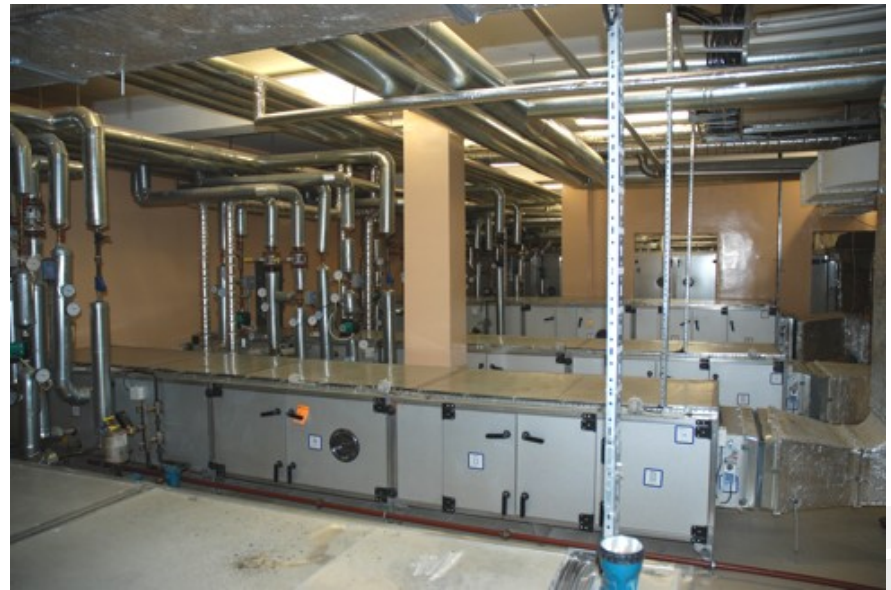
Размещение центральных кондиционеров в помещении
