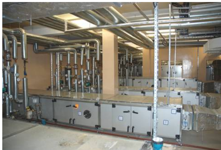
Размещение центральных кондиционеров в помещении
